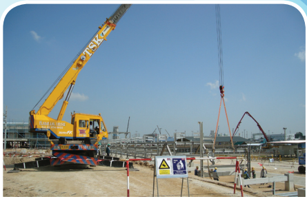
ลักษณะงานที่ต้องมีใบ Work Permit
