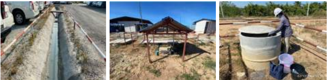
ภาพรางระบายน้ำชั่วคราว, ระบบบำบัดน้ำเสียสำเร็จรูปและการตรวจวัดคุณภาพน้ำทั้งในพื้นที่โครงการ
