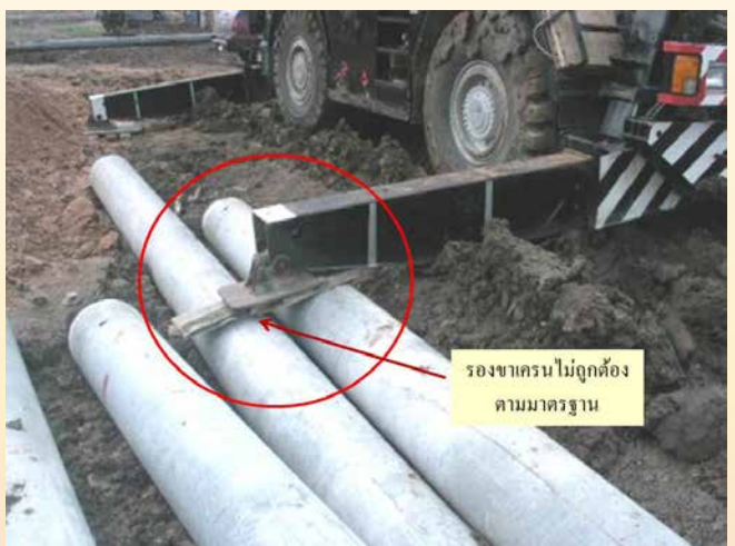
ลักษณะการทำงานที่ไม่ปลอดภัย ต้องออกใบแจ้งภัยสภาพงานไม่ปลอดภัย
