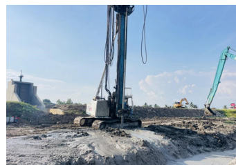
เครื่องจักรดำเนินงาน SCC ระบบ Jet Mixing
